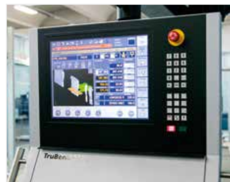
Pannello di controllo
